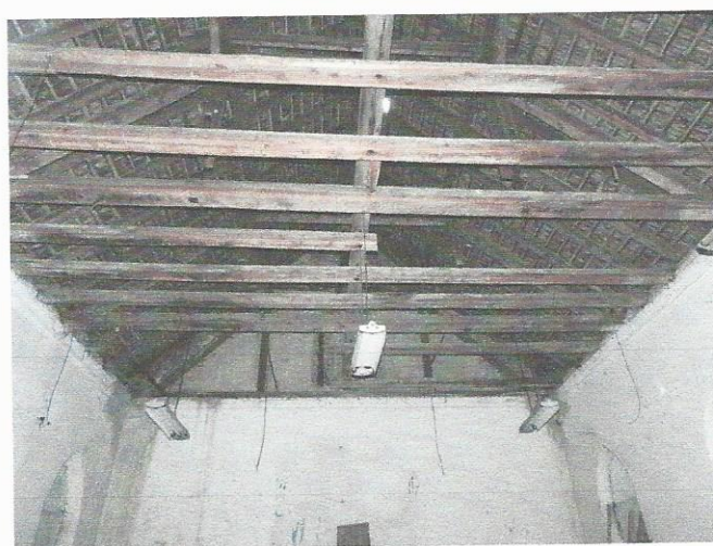
Fot. 11. Zniszczone poddasze analizowanego budynku.
