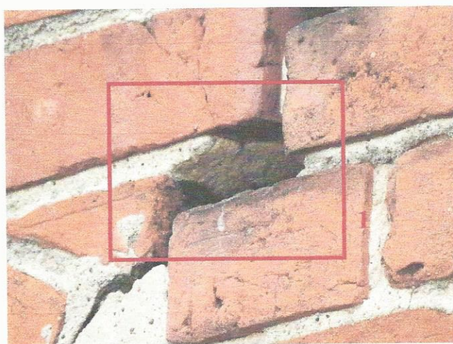
Fot. 6. Miejsce lęgowe wróbla w ubytku zaprawy.
